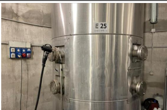
Foto 1 – Particolare bocchelli e quadro prese corrente E 25
