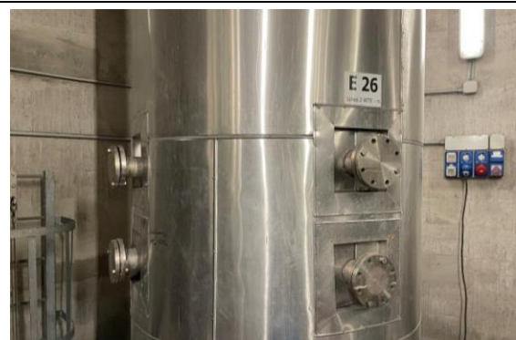
Foto 2 – Particolare bocchelli e quadro prese corrente E 26
